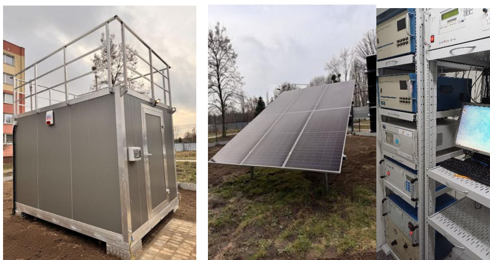
Rys. 3 Widok na stację pomiarową AM3 po gruntownej modernizacji. Materiały pozyskane od ARMAG
